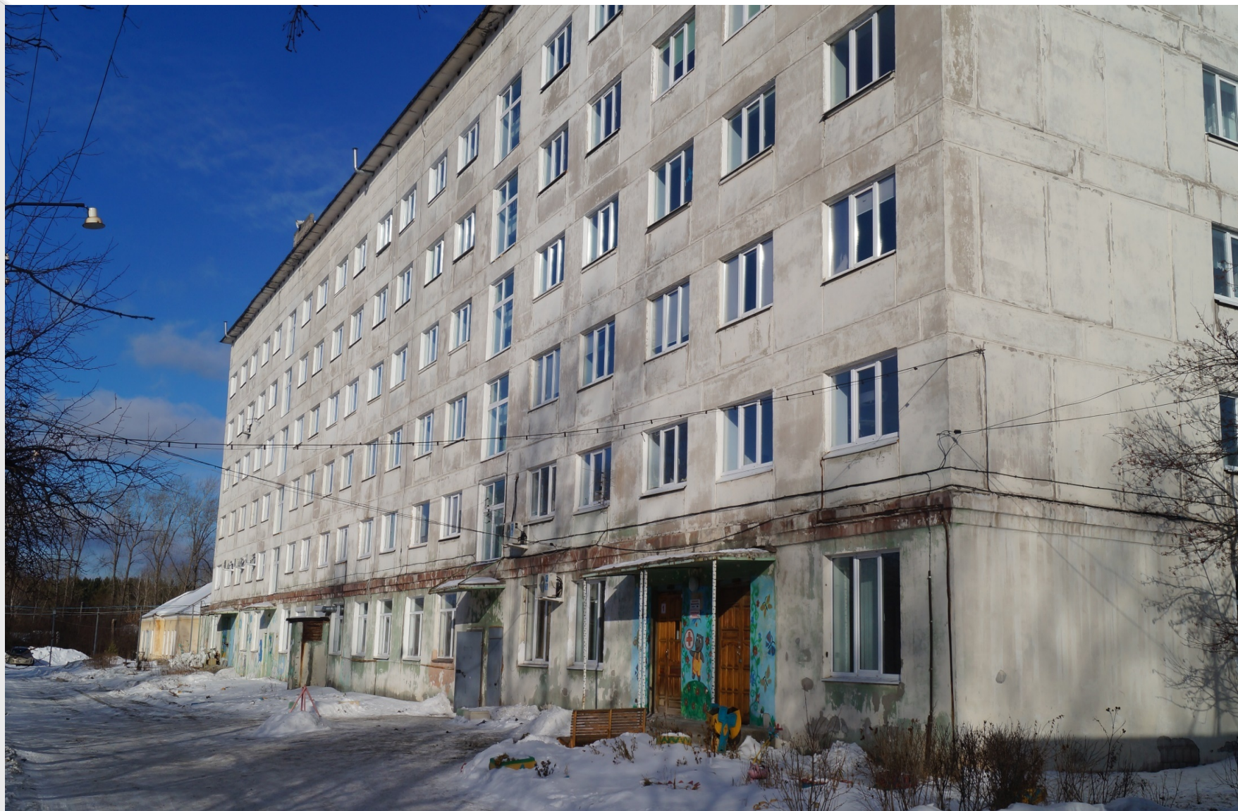
Здание главного корпуса городской инфекционной больницы г. Нижний Тагил. Дата открытия больницы 01.01.1976 г.
